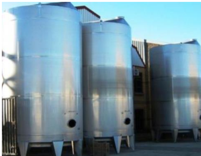
Gráfico N° 5.5.7.1 – Tanques industriales de encalado. Fuente: Fives Cail.
