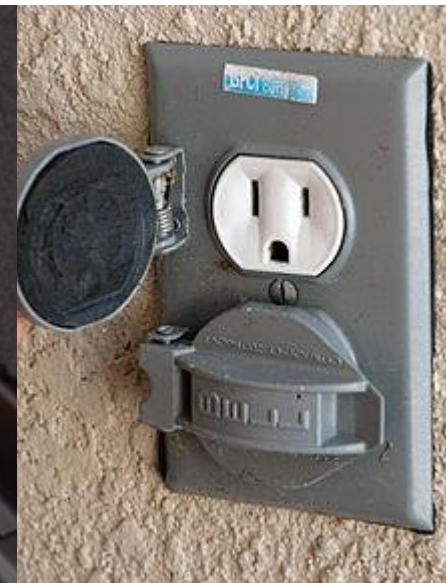
Toma de corriente eléctrica
