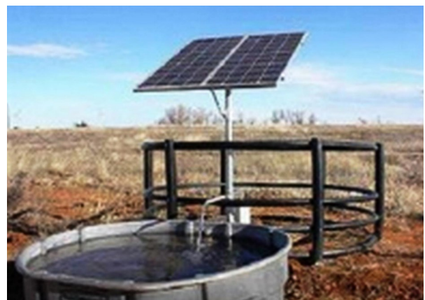
Bomba solar de agua
