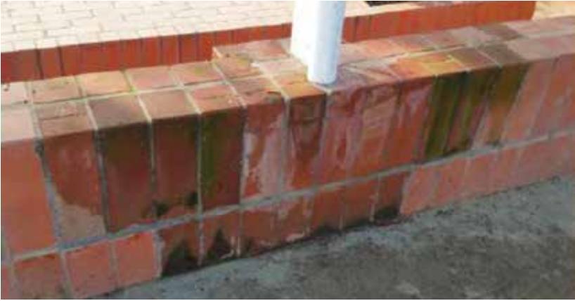
Manchas por presencia de humedad en el muro
