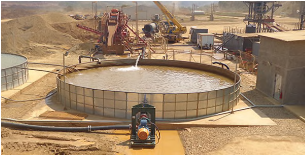
DEPOSITO DE AGUA PARA LAVADOS // WATER TANK FOR WASHING
