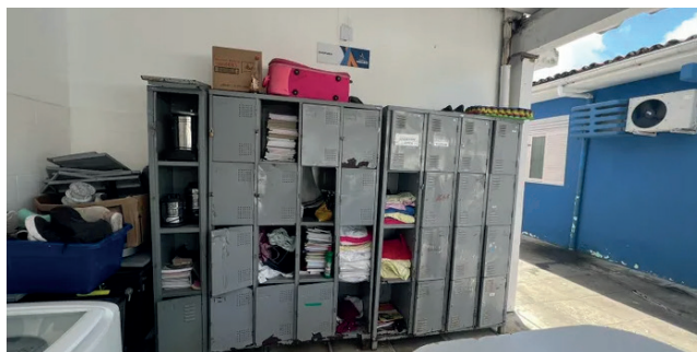
CASA LAR tem várias deficiências, entre elas armários bem danificados
