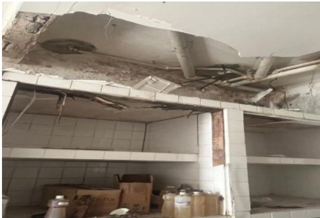
INFILTRAÇÕES E FORROS deteriorados estão entre problemas do espaço
