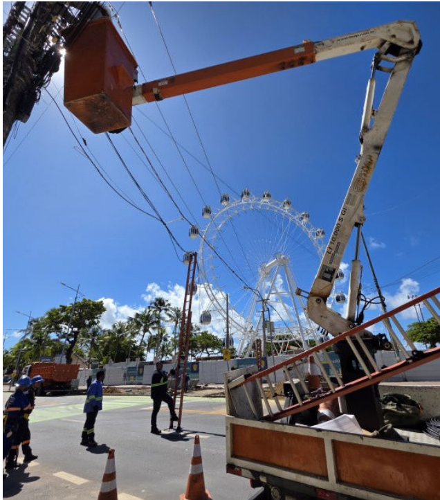
CABOS INATIVOS podem causar acidentes e traz poluição visual
