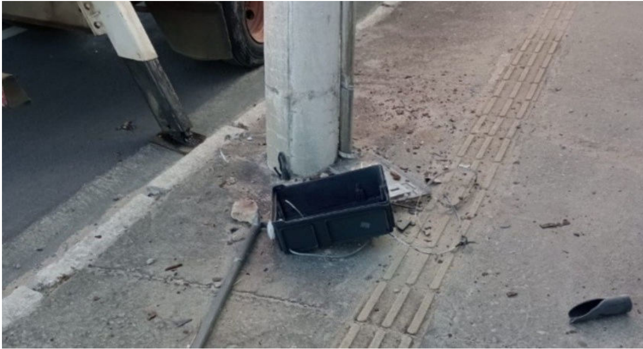
VÂNDALOS danificaram comando da rede de iluminação no Trapiche da Barra e levaram cabos de energia
