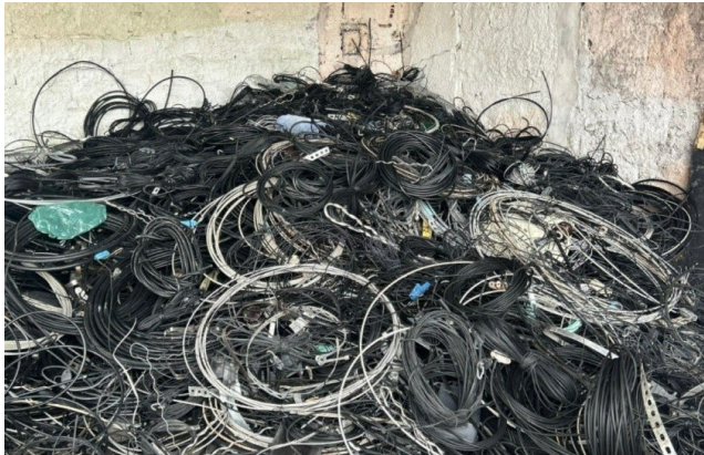
CABEAMENTO OBSOLETO representa risco para a população
