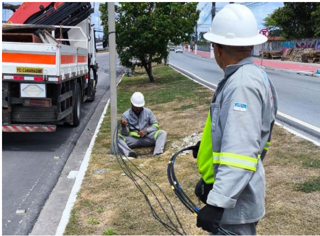
TÉCNICOS DA ILUMINA constataram furto de 5 mil metros de cabos
