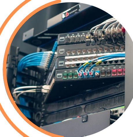
INFRAESTRUCTURA DE TI CABLEADO ESTRUCTURADO Y FIBRA ÓPTICA
