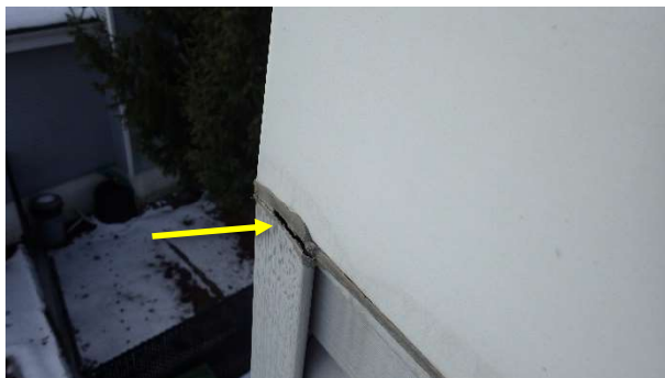
Autour du revêtement de vinyle dans le haut de la cheminée
