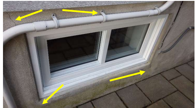
Fissures autour de la fenêtre façade arrière
