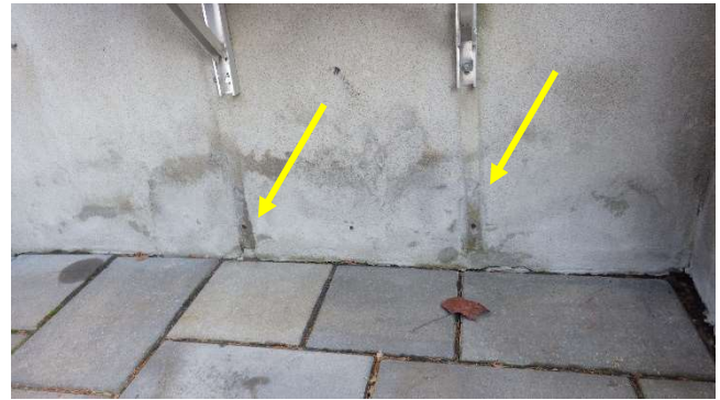
Crépis à réparer façade latérale gauche
