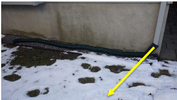
Éloigner les rallonges aux sorties de gouttière
