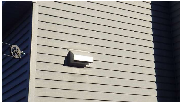
Sortie hotte de cuisine côté gauche
