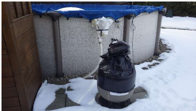
Prise électrique pour piscine à vérifier si sur DDFT
