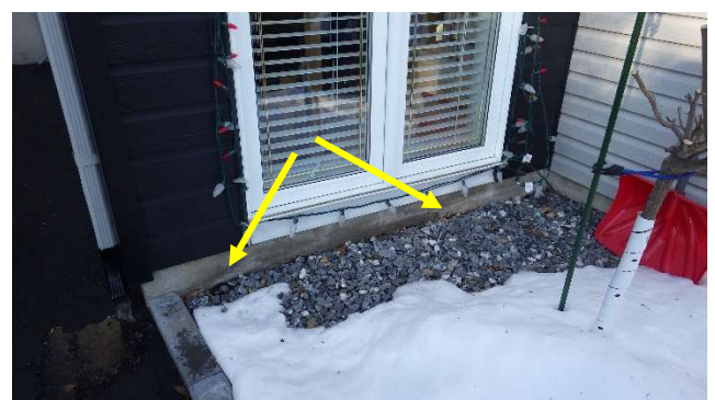
Crépis à réparer sous la fenêtre façade avant
