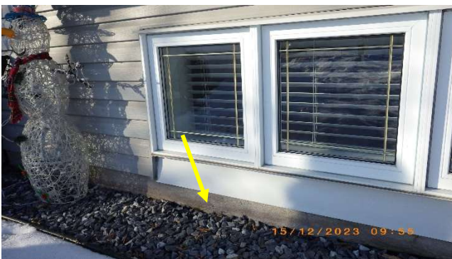
Crépis à réparer sous la fenêtre façade avant
