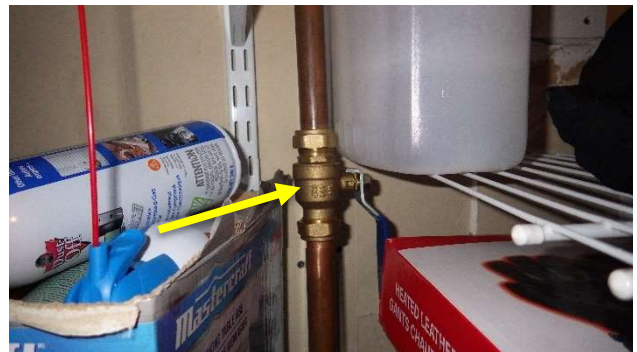
Nouvelle valve d'arrêt entrée d'eau
