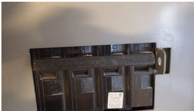
Disjoncteur principal 150 ampères
