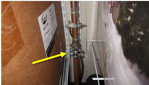
Valve d'arrêt d'origine entrée d'eau
