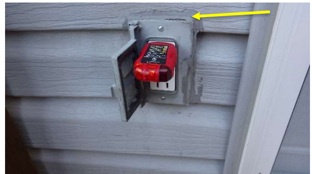
Prise de courant balcon arrière
