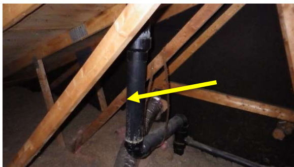
Évent de plomberie visible de l'entretroit
