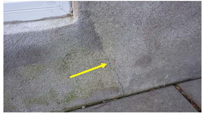
Vue rapprochée fissure coin bas de la fenêtre
