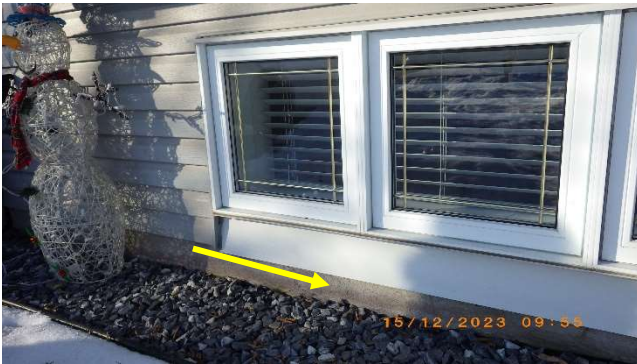
Fissure façade avant sous la fenêtre
