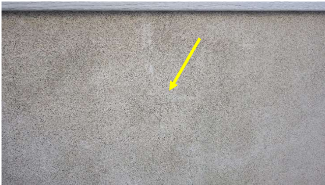
Crépis à réparer façade latérale droite
