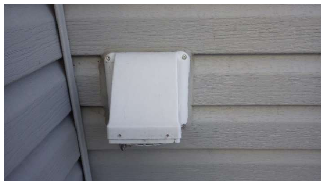
Sortie extérieure sècheuse
