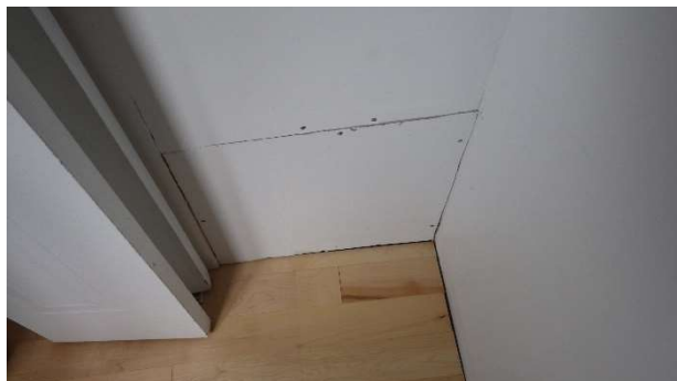
Ouverture à réparer et repeindre
