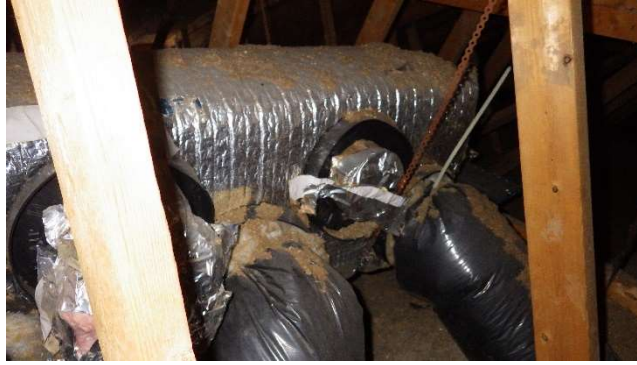
Système de climatisation centrale à démanteler
