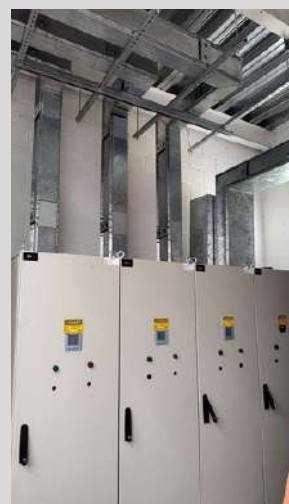
BARRAMENTO BLINDADO E QGBT
