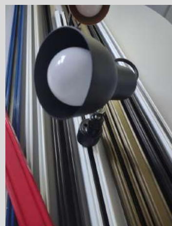
TRILHOS EM CORES VARIADAS COM TOMADA PLUG-IN E LUMINÁRIA
