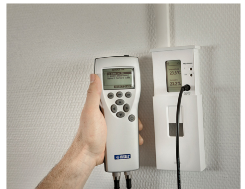
Calibración en terreno con el medidor portátil HM70
