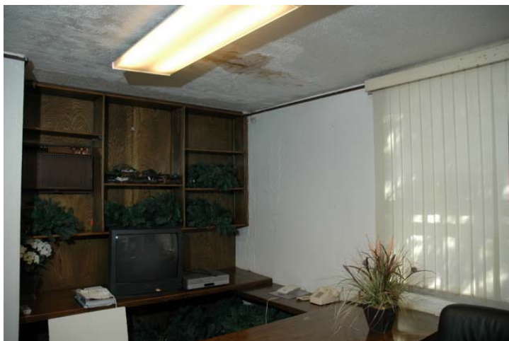
Šajā attēlā skaidri redzami mitruma sabojātie mācītāja biroja griesti
