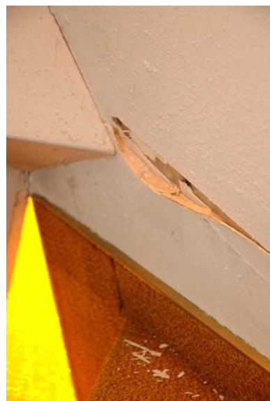
Mitruma bojājumi baznīcas balkonā
