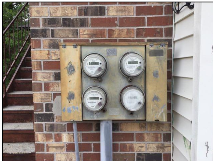
27. Breakers - exterior wall
