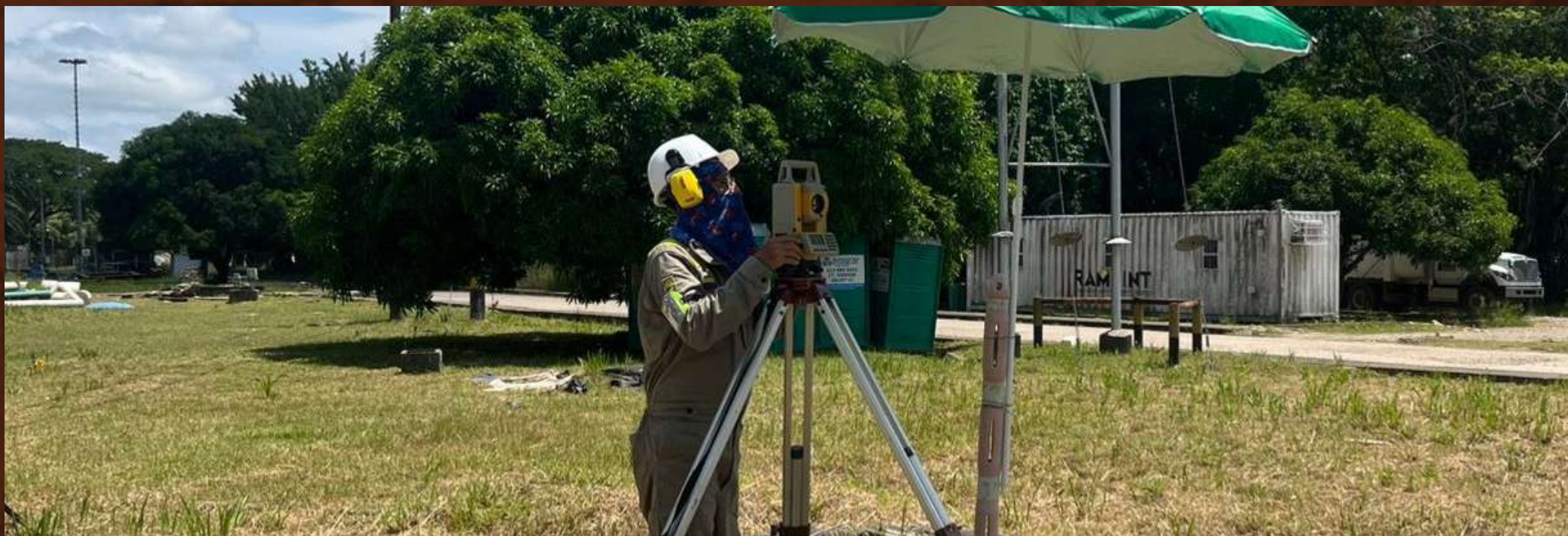
Refinaria Ecopetrol - Colômbia
