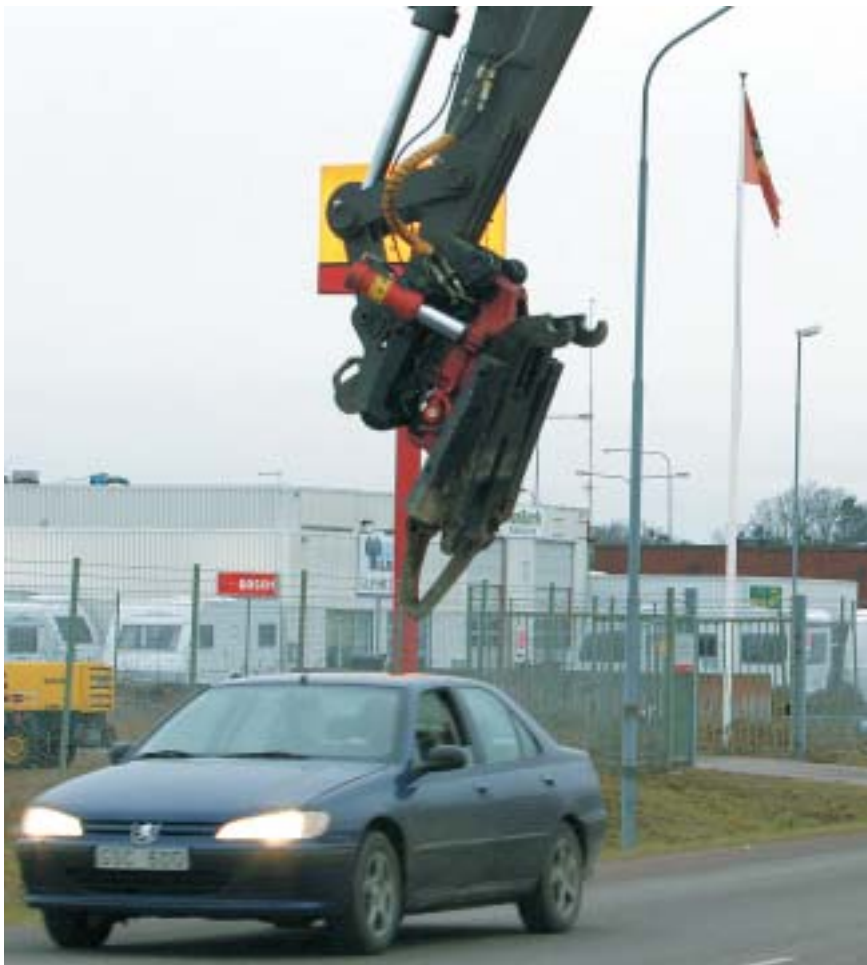
Det gäller att ha kontroll över var man har maskinens lyftgafflar, för att undvika slarvskador.
