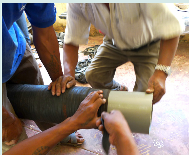
Figura 16: Imagen que ilustra la necesidad de continuar el amarre de liga de neumático 10 cm más, una vez cubierto el plástico, sobre la tubería.
