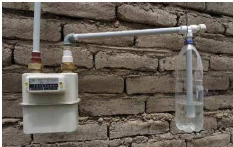
Ilustración 15. Flujoímetro (Medición producción de biogas) y válvula de alivio de presión.
