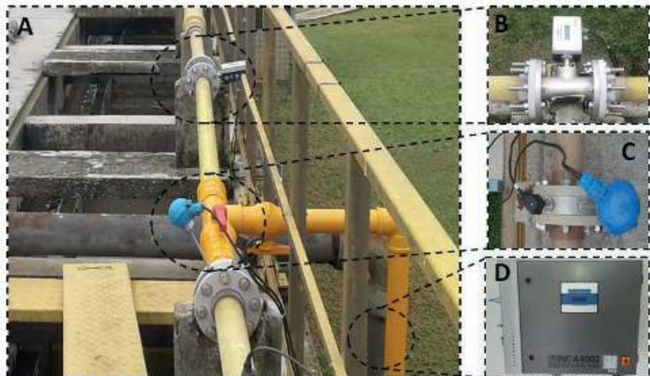
Figura 1 | Equipamentos de medição instalados na ETE: (A) visão geral dos medidores e da tubulação de biogás; (B) medidor de vazão de biogás do tipo vórtex; (C) medidor de temperatura e pressão; (D) medidor de gases (CH 4 , CO 2 , O 2 , H 2 S).
