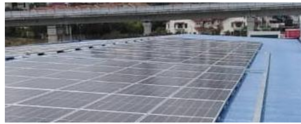
800kWp NEM @ Puchong 2020
