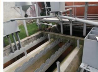
Tuberías a remplazar
