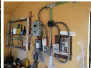
Conexiones eléctricas a remplazar
