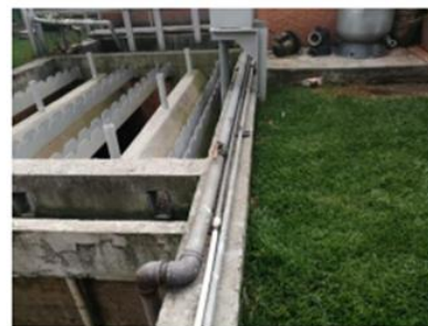
tubería a reemplazar
