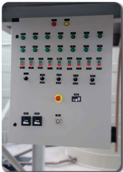
Quadros de Comando para ETA, ETE e ETDI
