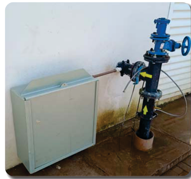
Equipamento de Cloração
