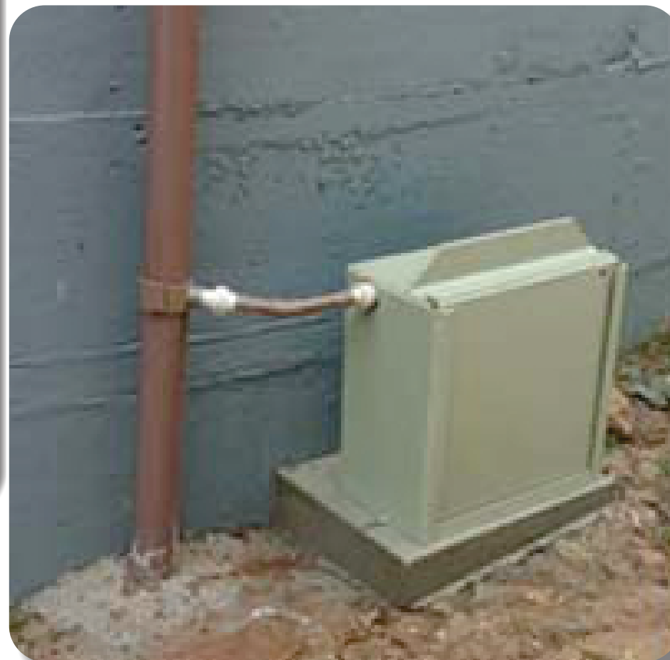
Sistema de desinfecção de água (clorador)
