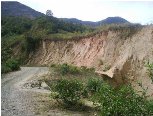
Tramo en riesgo
