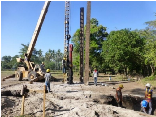
MONTAJE DE PILOTES DE FORMA PARA COMENZAR A HINCARLOS EN TERRENO MARINO
