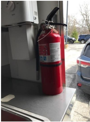
ABC Extinguisher 3A:40BC /1A:BC
