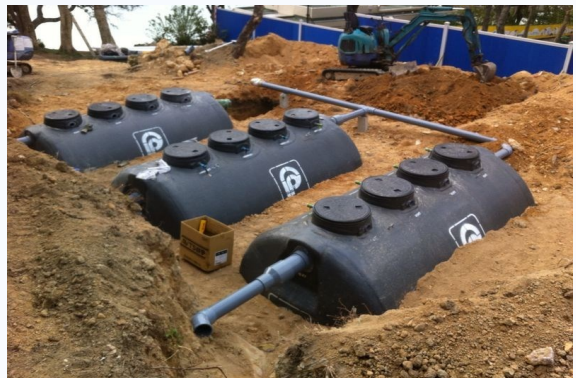
西貢離島污水處理設備 AWTS in Sai Kung Islands
