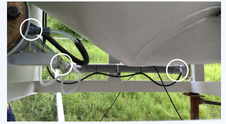
分隔的注藥入口 Separated Chemical Injection Point
