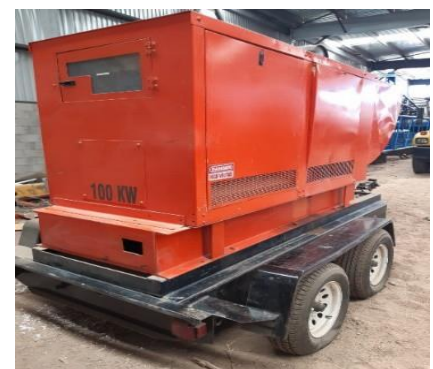
Generador de 100 KW diésel MQ Power capacidad 8 maquinas de soldar
