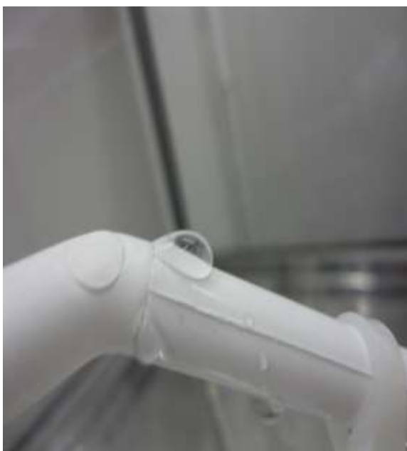
Figura 2 – Vazamento no aparelho.
