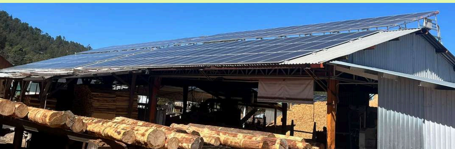
Imagen 9. Aserradero con paneles instalados para generar energía eléctrica.
