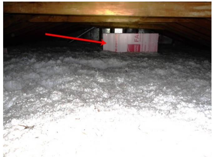
Attic fan barrier
