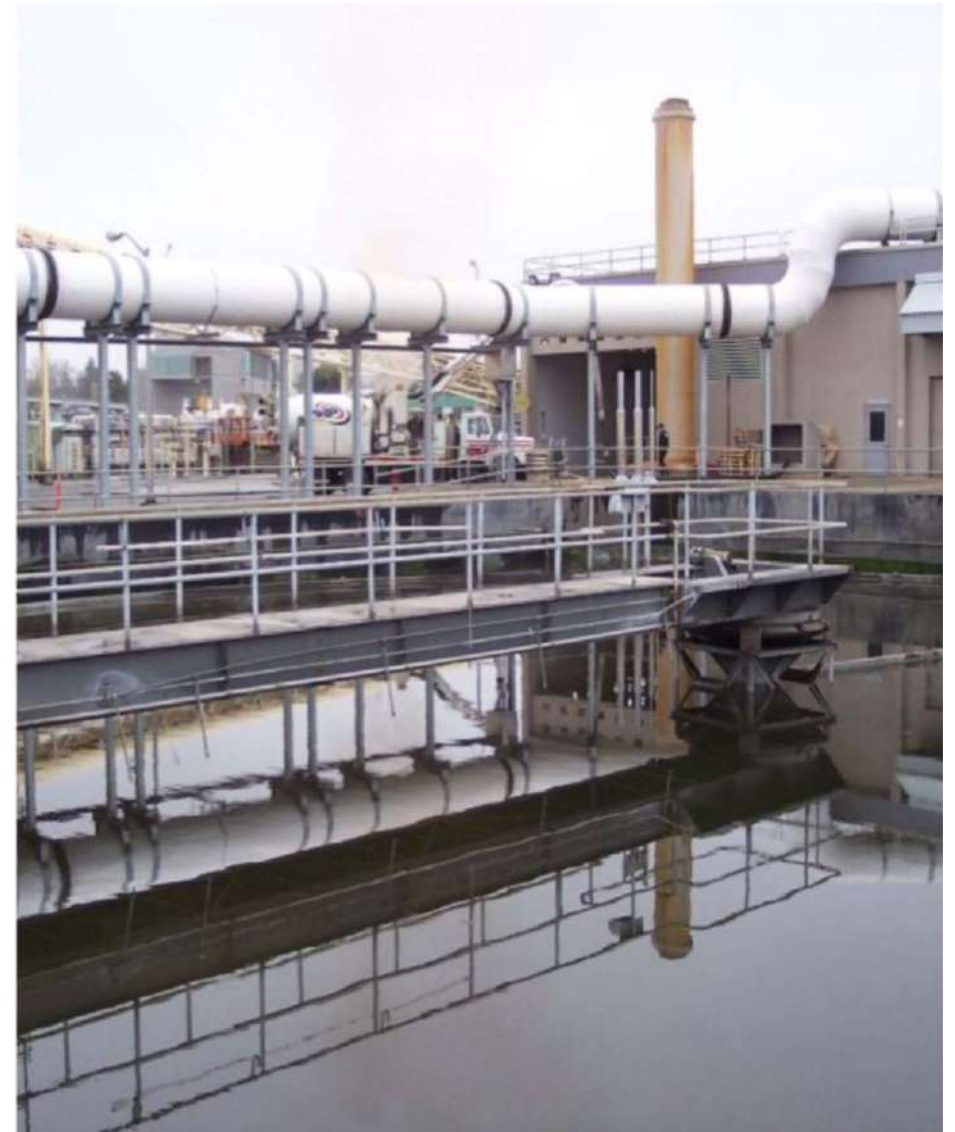
محطة الصرف الصحي بالدمام
