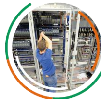
Schaltanlagen - und Steuerungsbau
