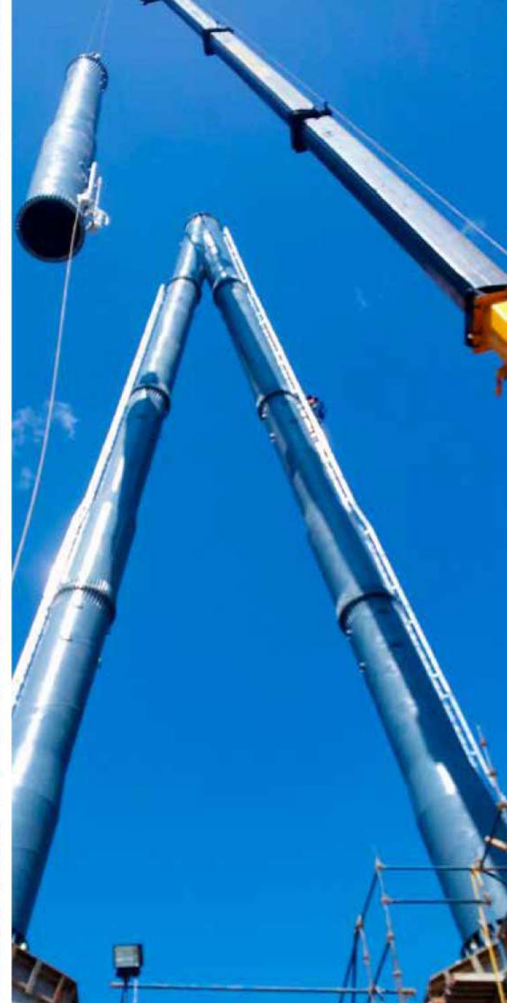
Pilona 4 - Cable Aéreo Villamaría
