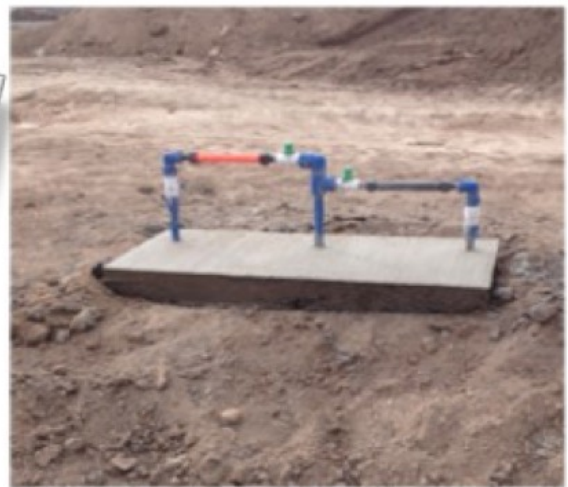
Cuadro medidor de polipropileno
