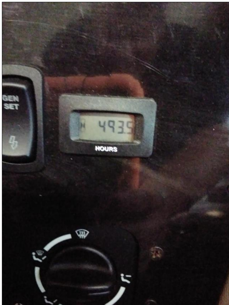
generator hour meter
