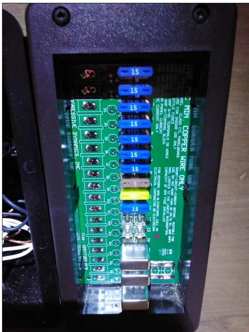
12 volt fuse panel
