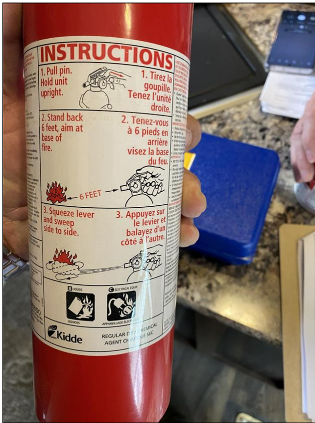
Ramp door extinguisher
