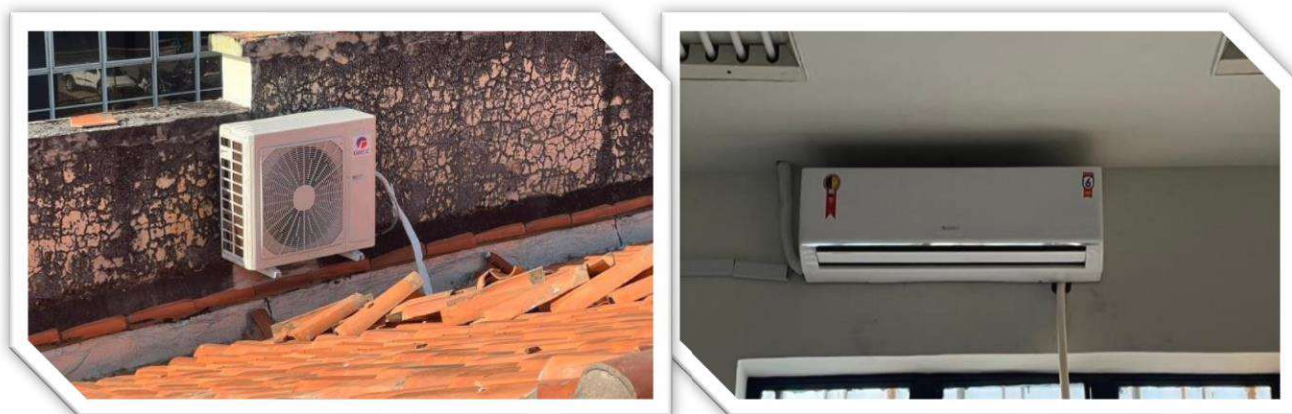
Foto 3: imagens do ar condicionado instalado
