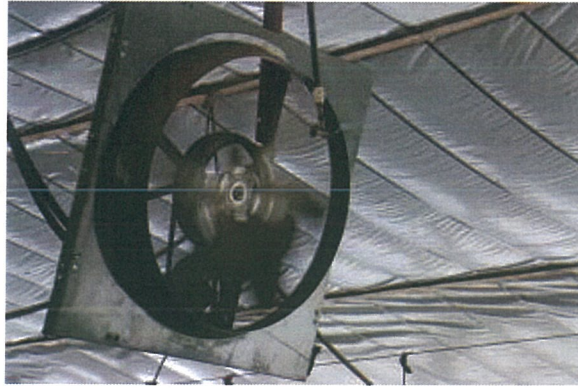
Plate 8: Sprinkler/ fan system
