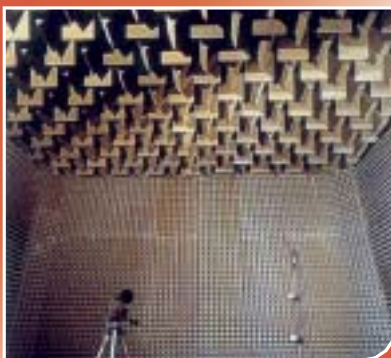
Mesures acoustiques Acoustic chamber
