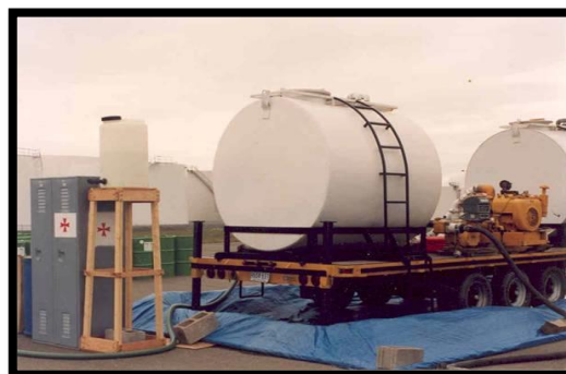
Figure 2.1 Citerne mobile dans un aménagement de rétention
