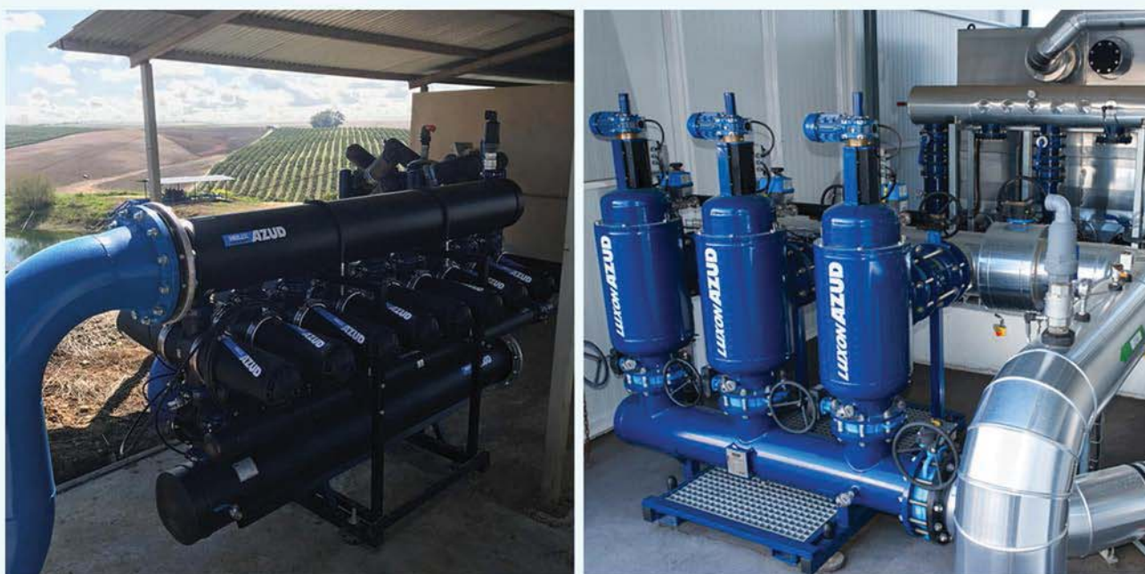
Hệ thống lọc tự động Azud : nước sau lọc từ 50 micron – 130micron
