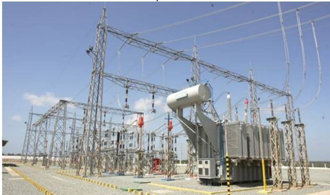
Visão geral de uma Subestação
