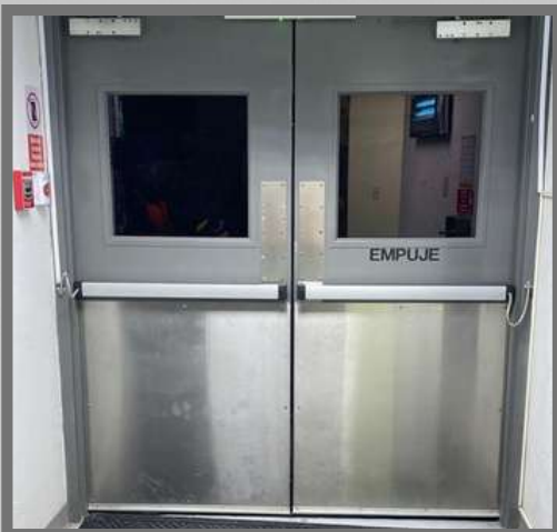
Placas de Acero Inoxidable en Puertas
