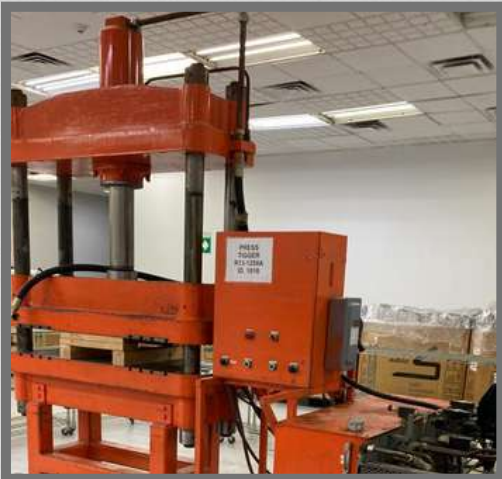
Instalaciones eléctricas de equipos
