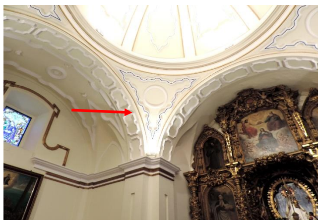
Foto 11: Una de las cuatro pechinas 77 situadas entre los arcos torales 78 sobre los que descansa el anillo de la cúpula de la iglesia de la ermita de Chilla
