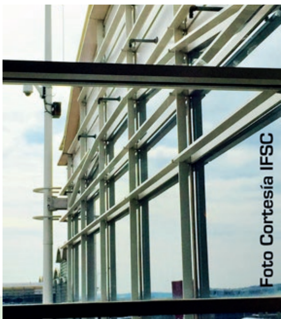
FACHADA DE LA TERMINAL PROTEGIDA CON ASPERSORES DE AGUA
